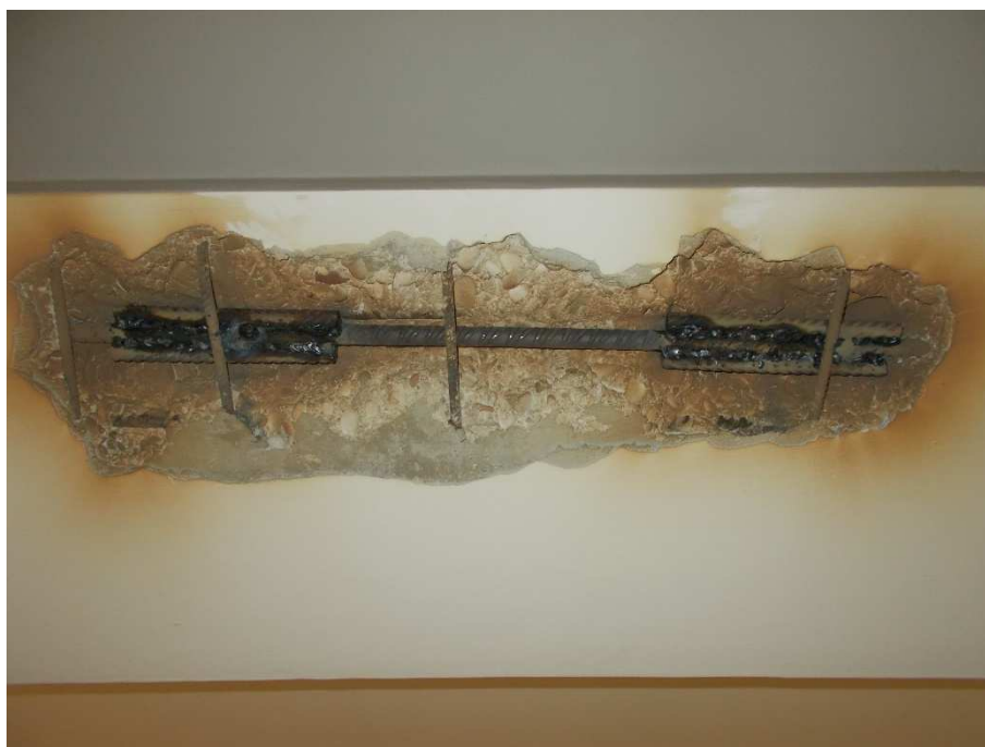
FOTO 4 – Piano Primo. Barra di armatura “F2” prelevata e ripristinata mediante saldatura
