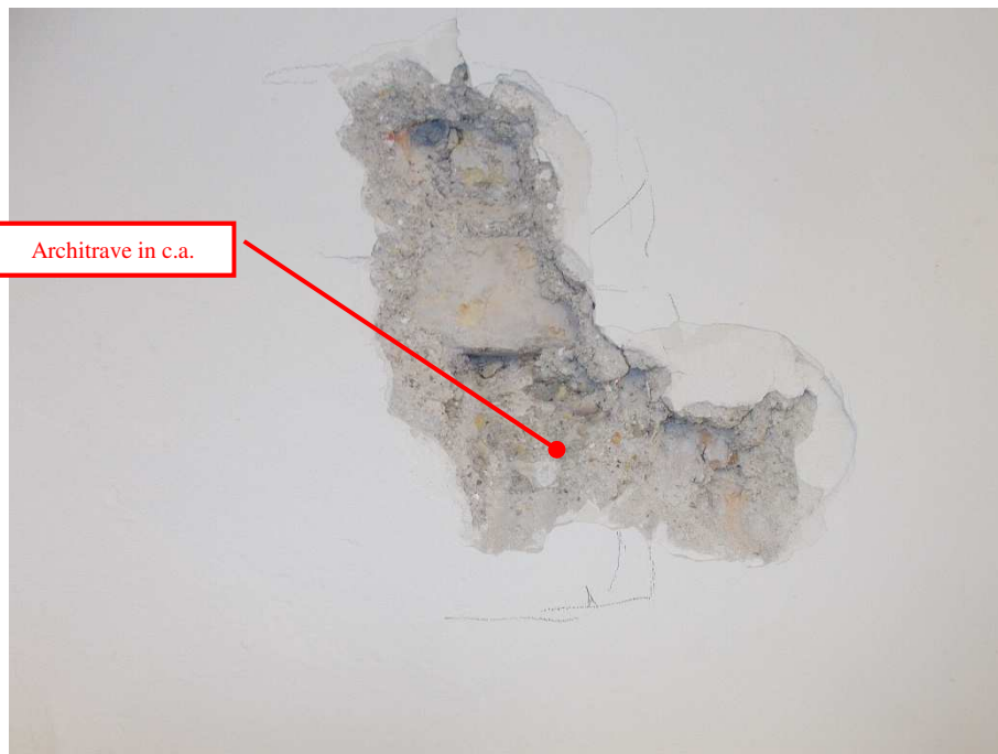
FOTO 8 – Piano Terra. Architrave in c.a. con tratto di appoggio di circa 30 cm.
