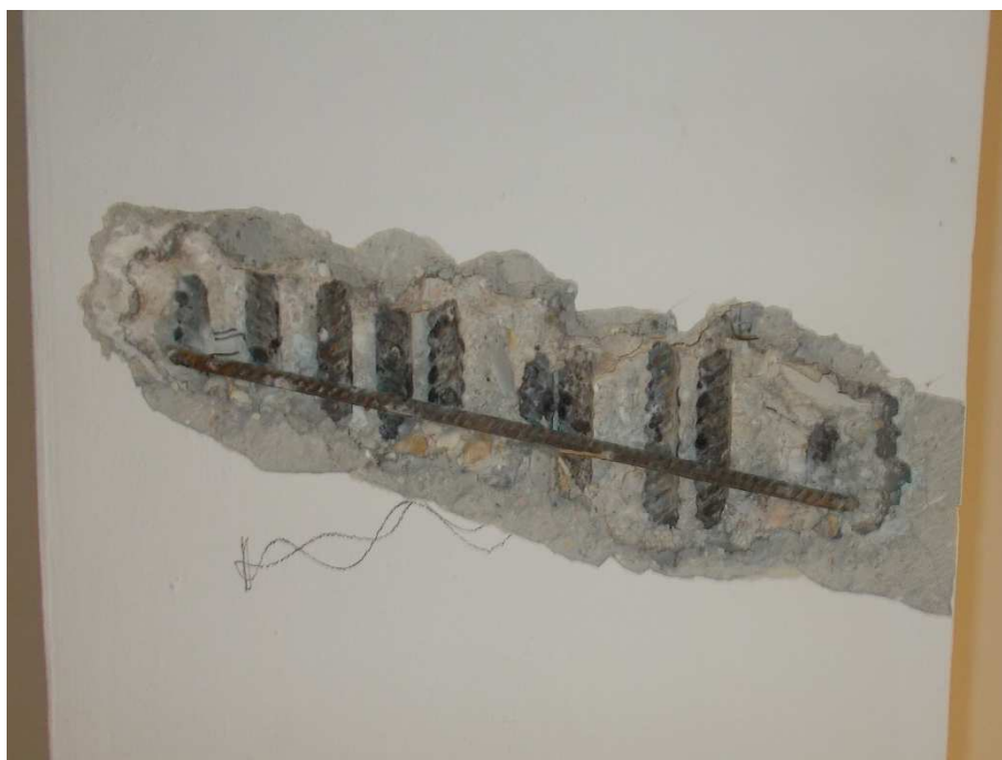
FOTO 2 – Piano Primo, Trave 8 - 9. Ferri di armatura e staffa, individuati nella Tab. 3.1, presenti all'intradosso della trave
