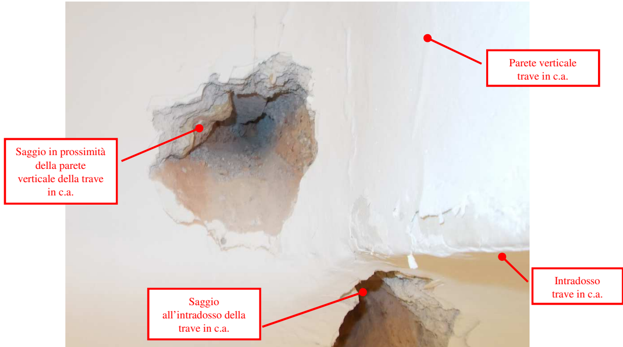
FOTO 7 – Piano Terra. In corrispondenza dei saggi non è presente un cordolo in cls
