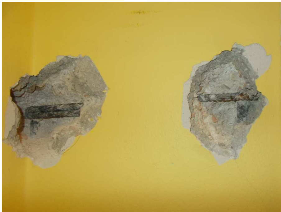
FOTO 1 – Piano Primo, Pilastro 5. Ferri di armatura e staffa, individuati nella Tab. 2.1
