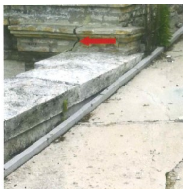
Fessure dall'esterno sulla copertura del portico e distacco del timpano
