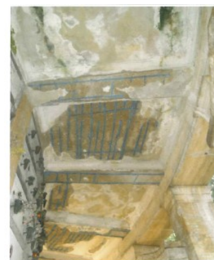
Soletta in c.a. ammalorata a copertura del portico frontale
