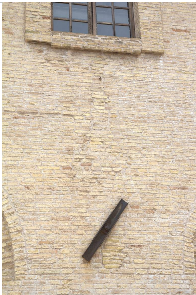
QF_1 :facciata esterna Fessure con espulsione muratura
