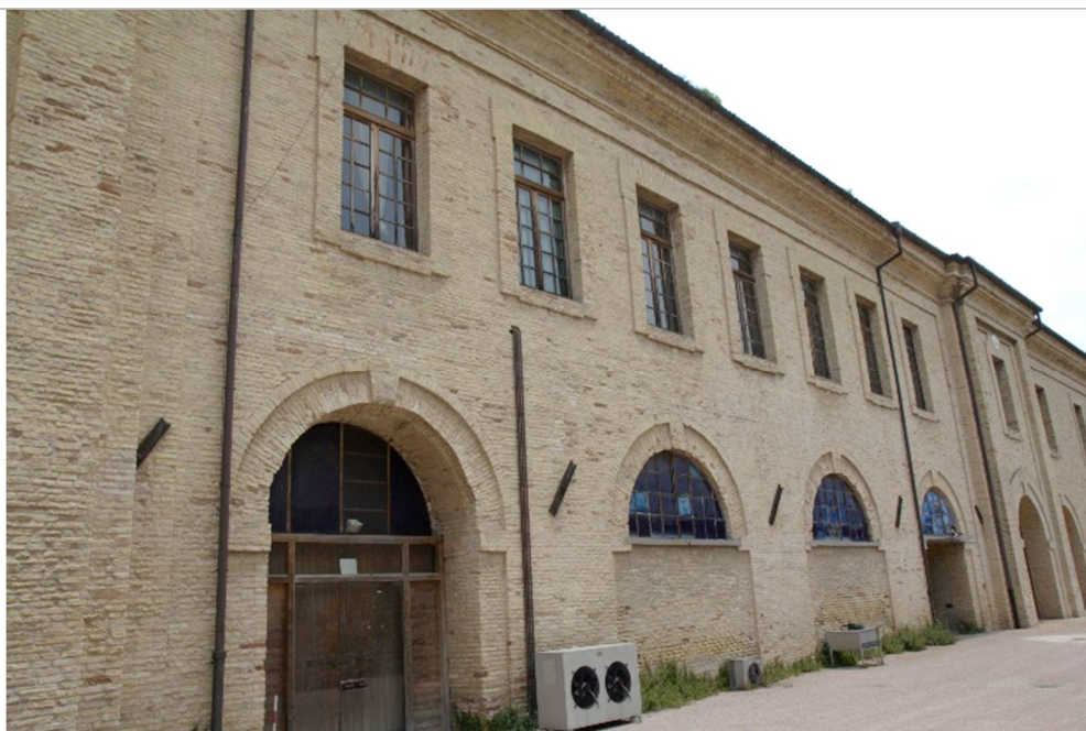
QF_2 :facciata esterna Fessure con espulsione muratura
