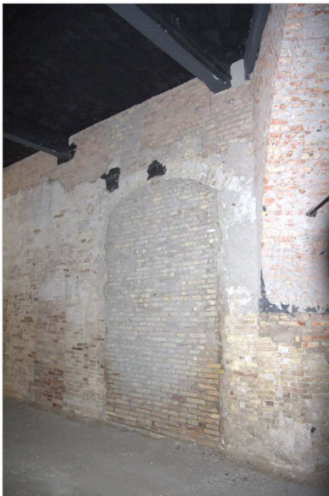
QF_27: quota 1,80 m Apertura parzialmente richiusa
