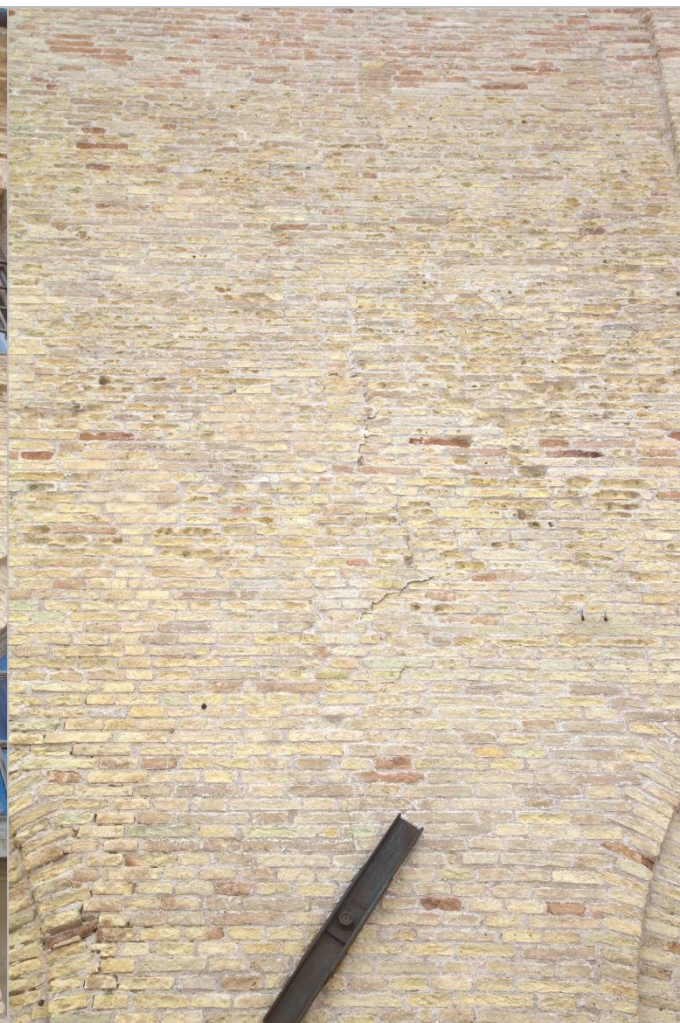
QF_6 :facciata esterna Fessure con espulsione muratura
