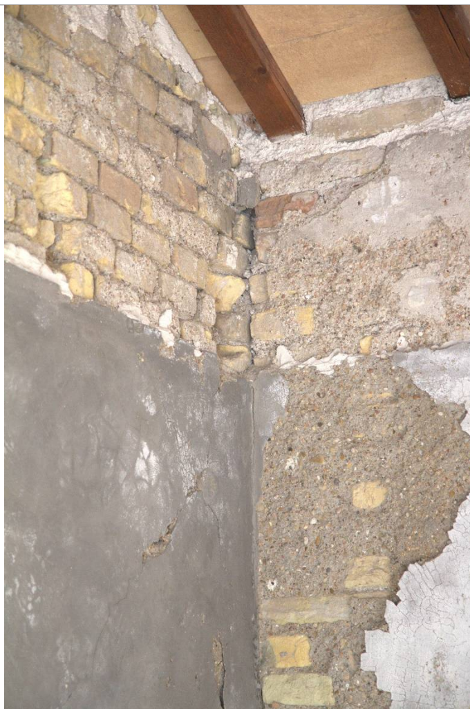
QF_94: quota 13,30 m Mancato ammorsamento
