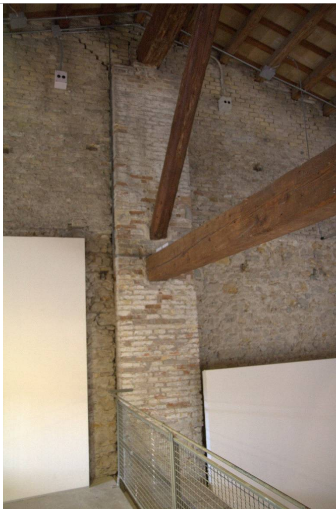
QF_75: quota 10,76 m Mancato ammorsamento
