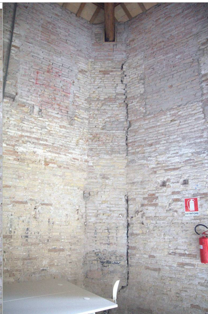
QF_3837: quota 7,80 m Mancato ammorsamento e fessura verticale
