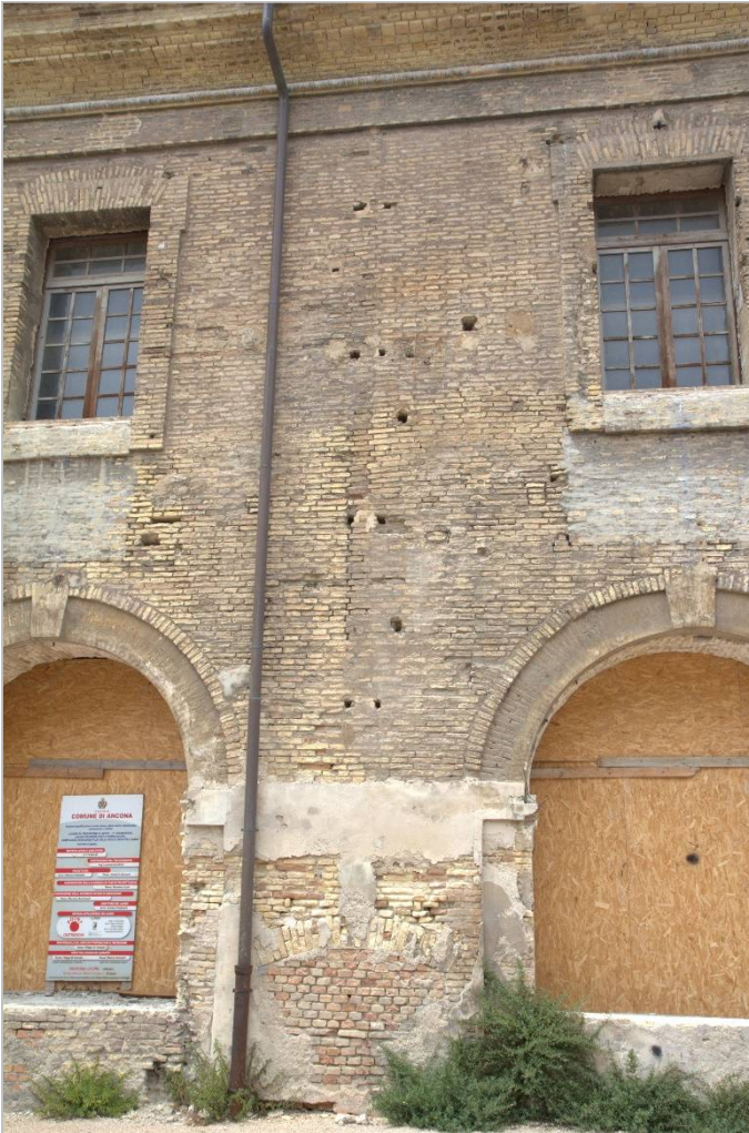
QF_13 :facciata esterna Presenza fessura verticale
