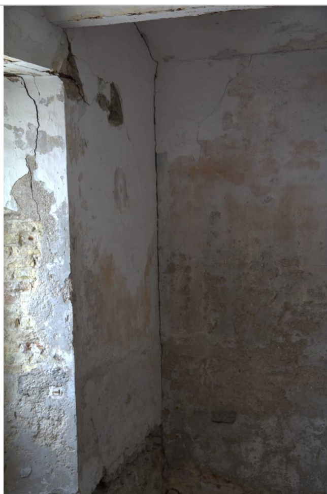
QF_56: quota 7,78 m Mancato ammorsamento
