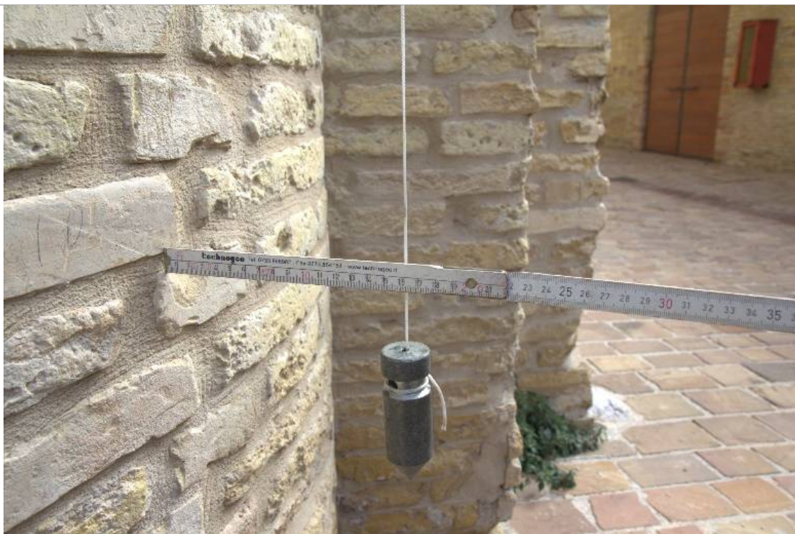
QF_17 :facciata esterna Problema di verticalità della parete
