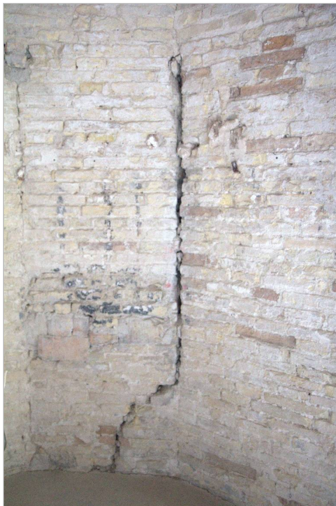
QF_39: quota 7,80 m Mancato ammorsamento e fessura verticale
