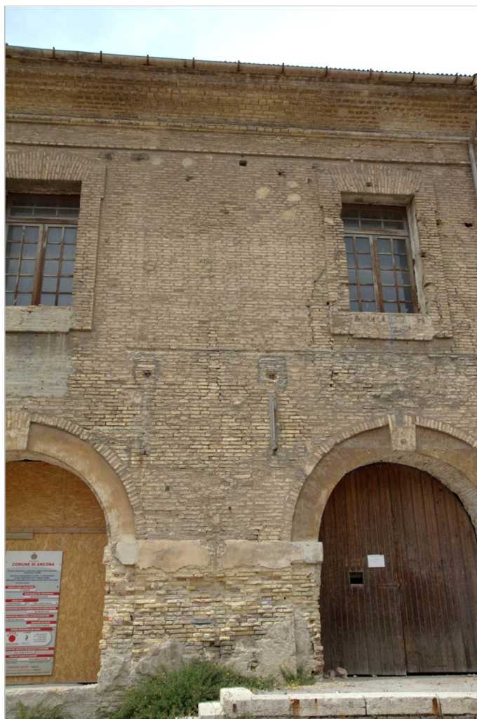
QF_11 :facciata esterna Presenza fessura verticale e degrado diffuso
