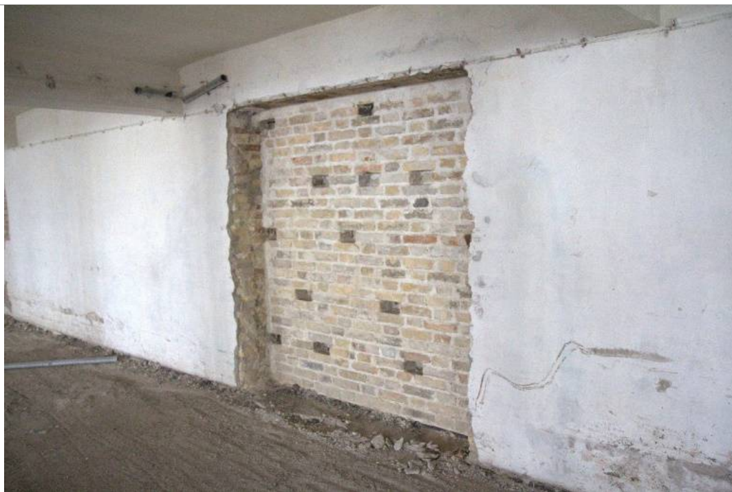
QF_60: quota 7,78 m Grande apertura parzialmente richiusa
