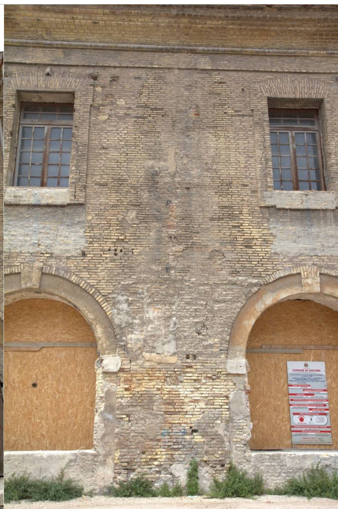
QF_12 :facciata esterna Presenza fessura verticale e degrado diffuso
