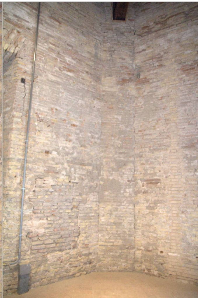
QF_46: quota 7,80 m Mancato ammorsamento agli angoli
