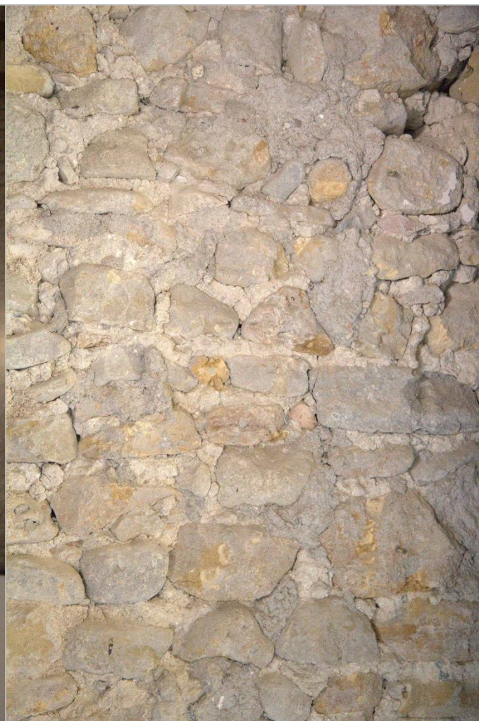
QF_74: quota 10,76 m Presenza di muratura disomogenea
