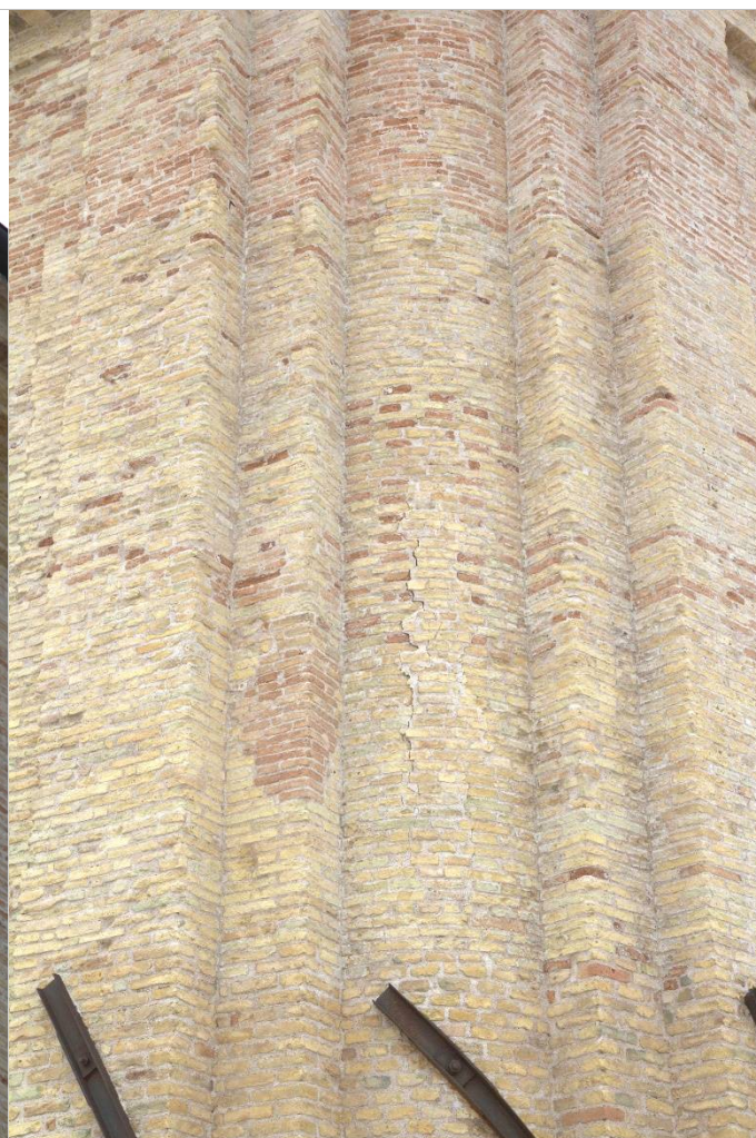
QF_8 :facciata esterna Fessure con espulsione muratura
