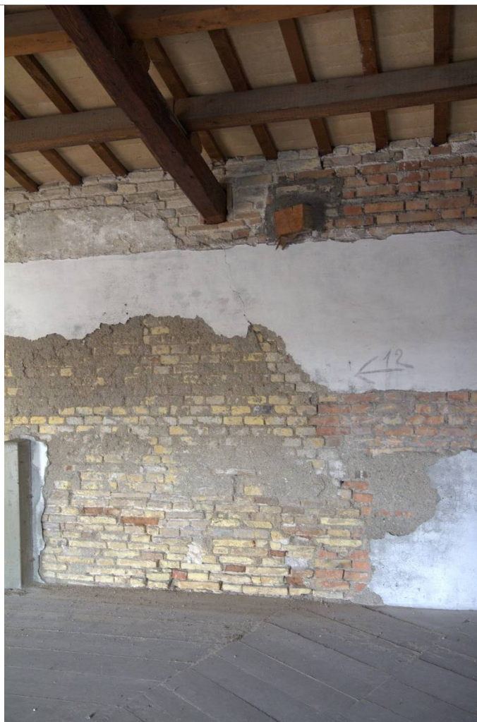
QF_33: quota 4,85 m Fessura diagonale
