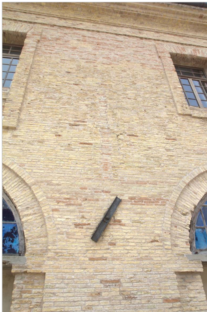
QF_5 :facciata esterna Fessure con espulsione muratura
