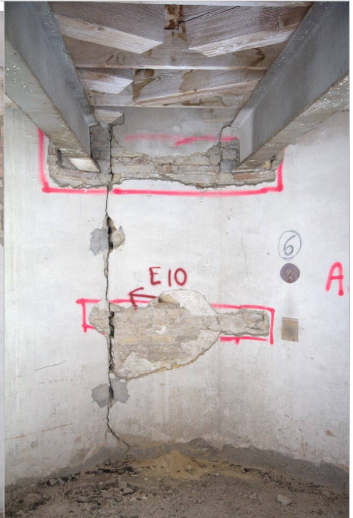
QF_64: quota 7,78 m Mancato ammorsamento agli angoli
