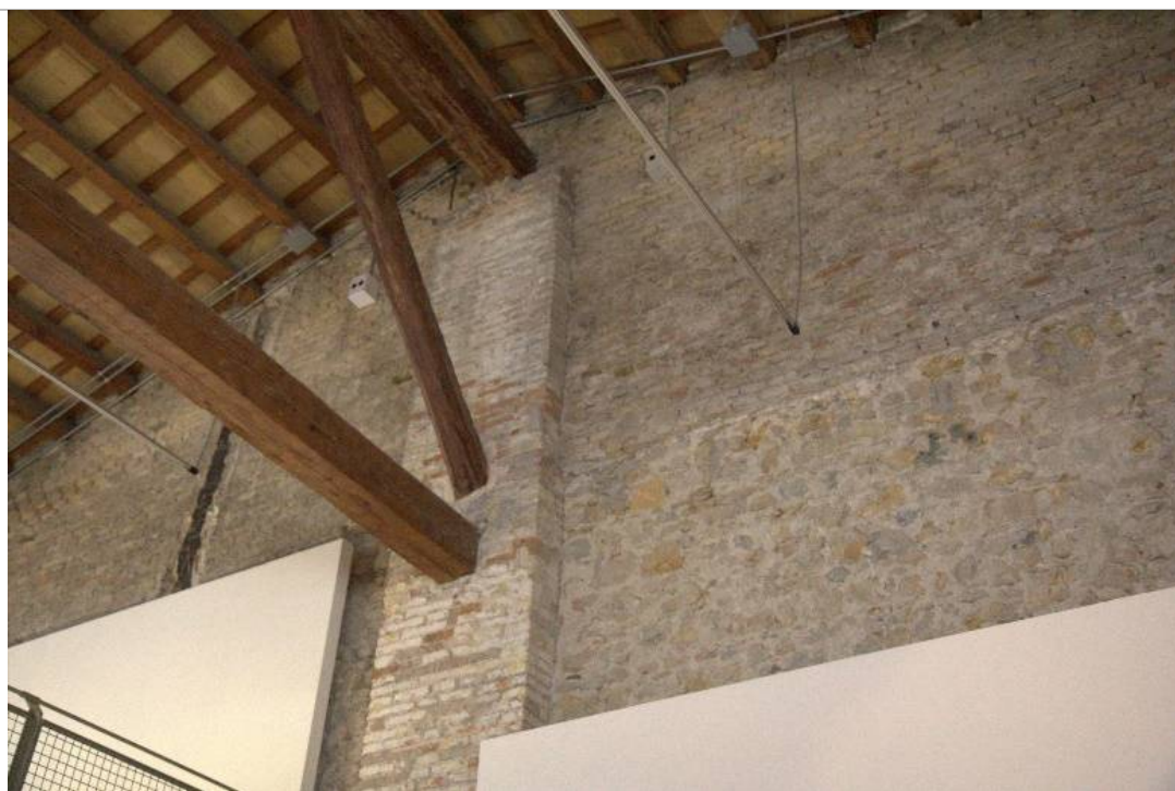
QF_76: quota 10,76 m Mancato ammorsamento
