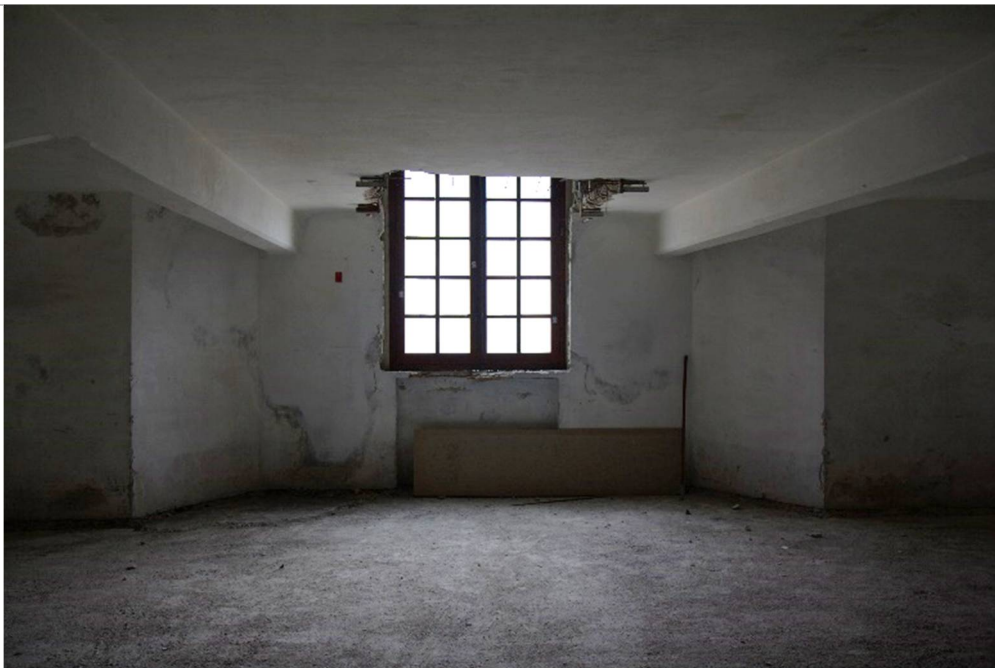
QF_61: quota 7,78 m Riduzione dello spessore della muratura
