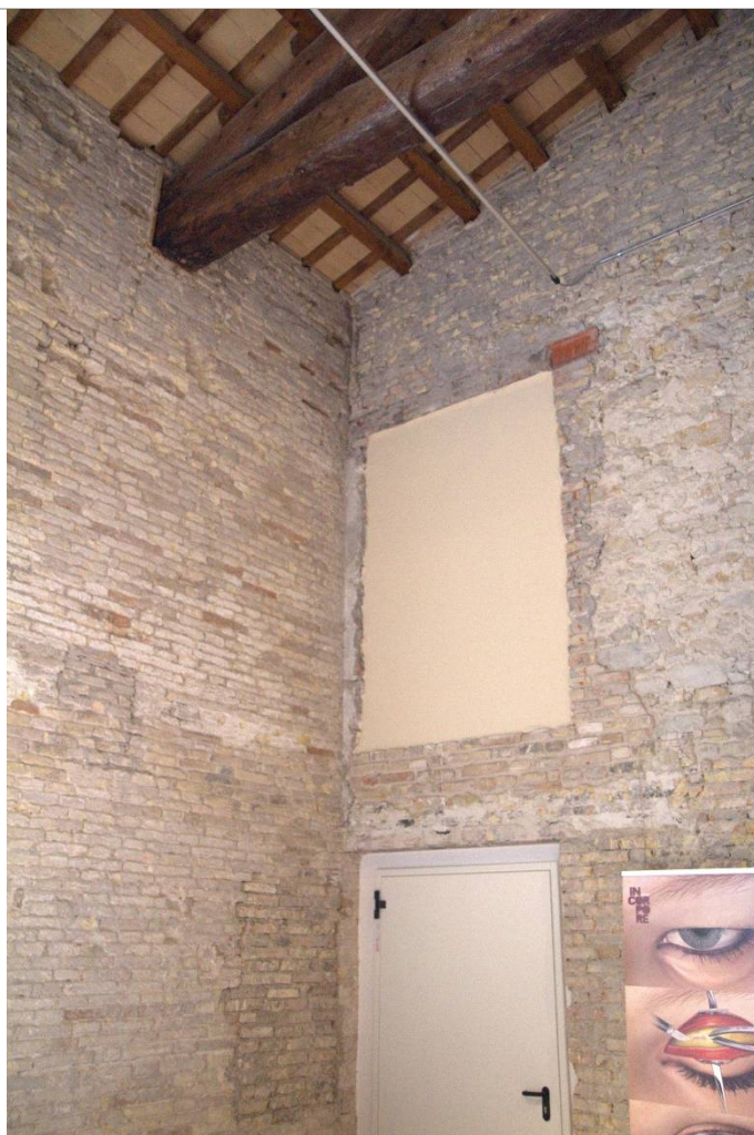
QF_49: quota 7,80 m Mancato ammorsamento
