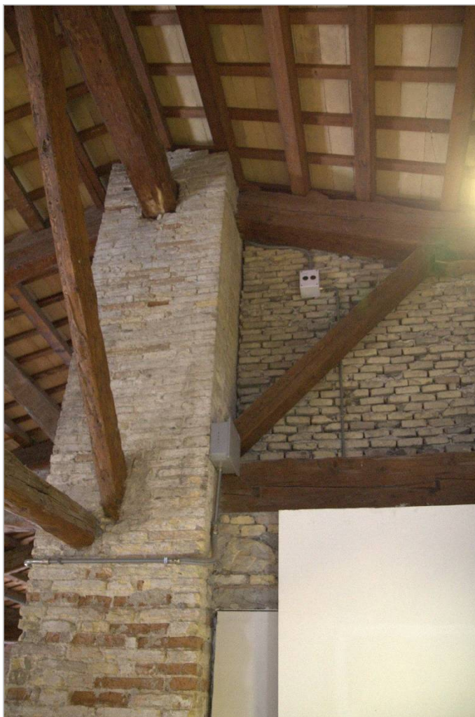
QF_81: quota 10,76 m Mancato ammorsamento
