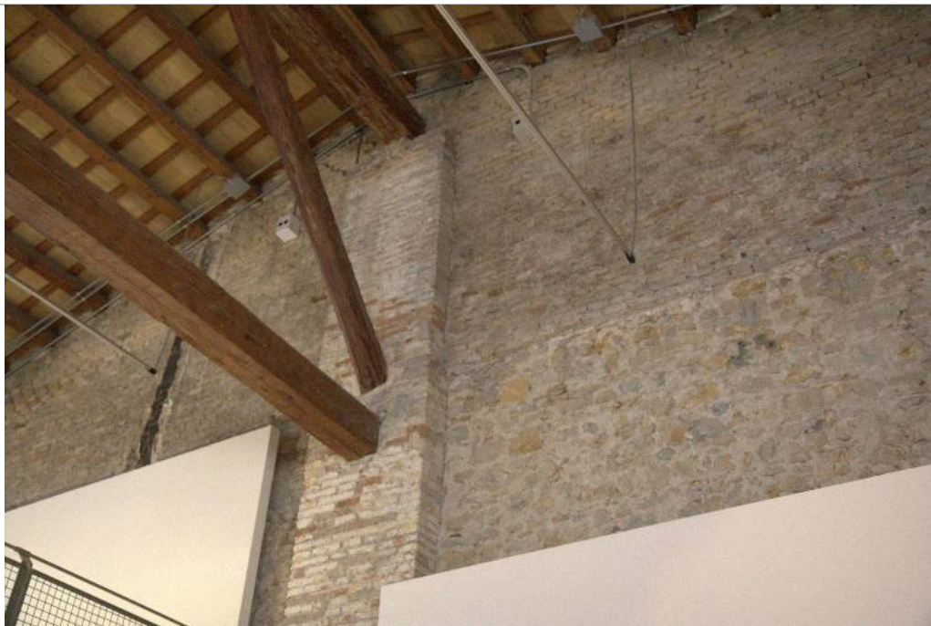
QF_43: quota 7,80 m Mancato ammorsamento
