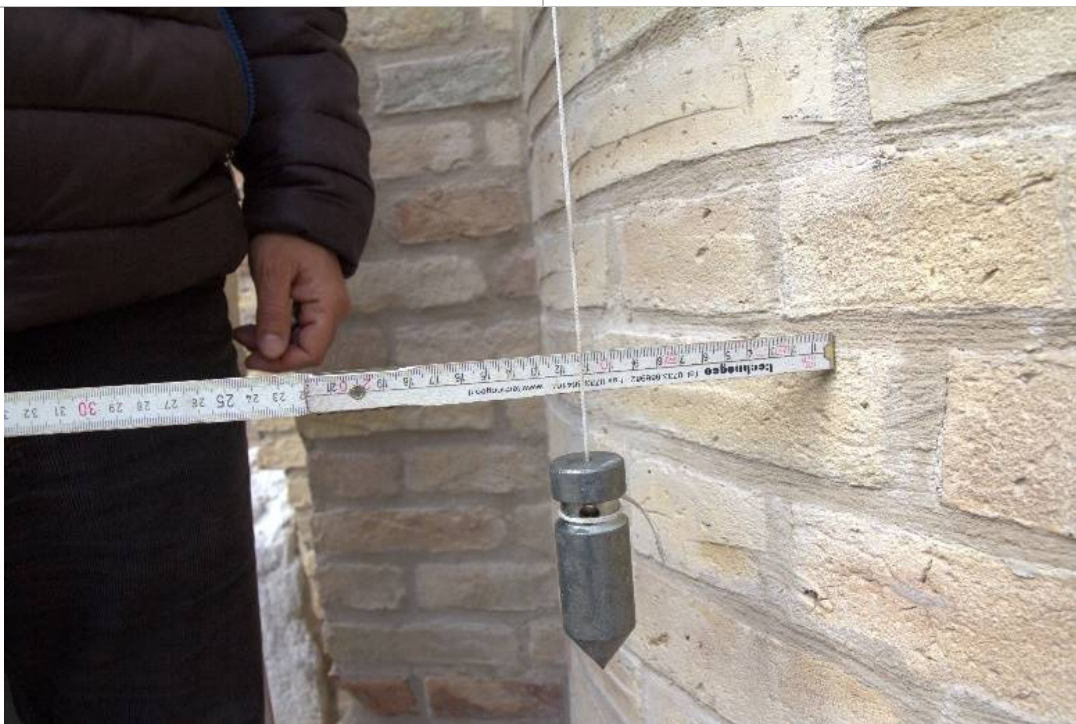
QF_15 :facciata esterna Problema di verticalità della parete
