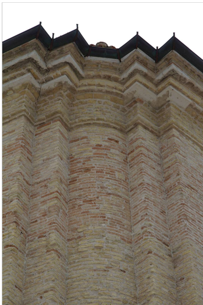
QF_7 :facciata esterna Fessure con espulsione muratura
