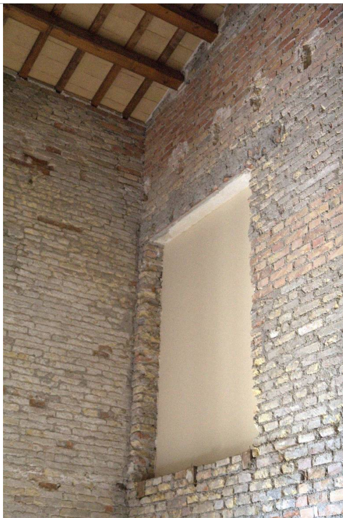
QF_53: quota 7,78 m Mancato ammorsamento
