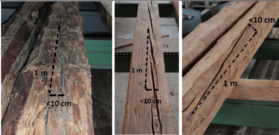
1) Esempio di misurazione dell'inclinazione della fibra, valutata su di una fessura
