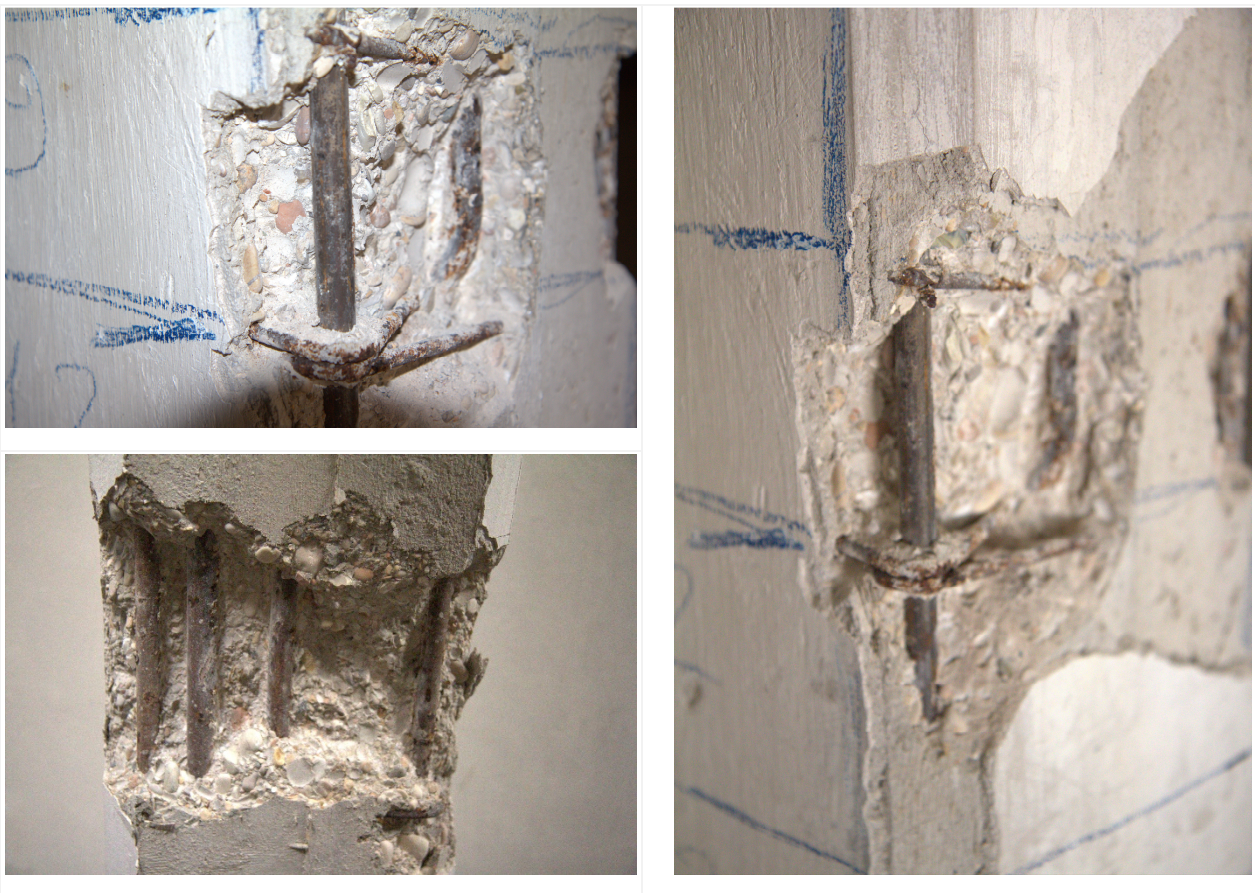
Figura 2-6 – Saggi su porzioni di pilastri: barre lisce e copriferri esigui
