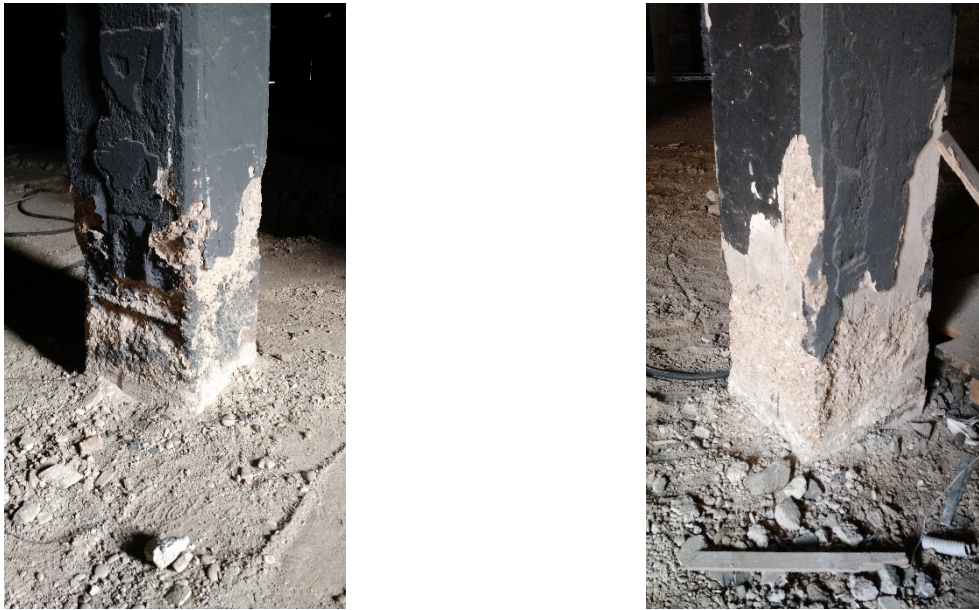
Figura 2-5 - Viste delle zone maggiormente ammalorate dei pilastri in calcestruzzo
