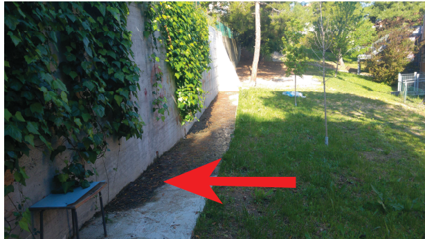
Fig. 6 – fuoriuscita d'acqua alla base del muro di contenimento di via Redi
