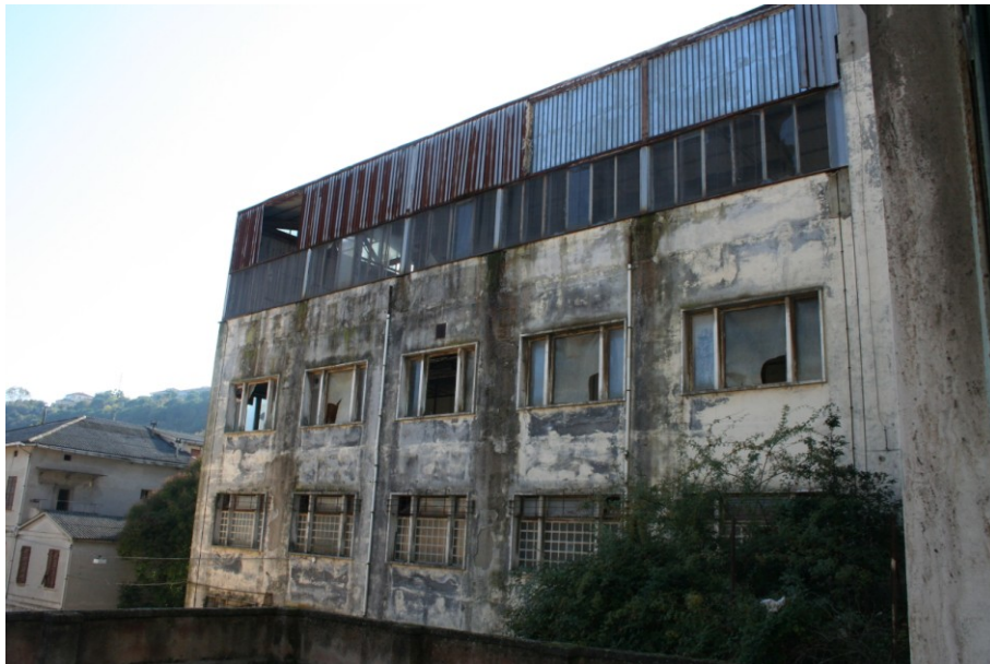
PIANO COSTRUITO IN ACCIAIO DA RIMUOVERE – COPERTURA IN AMIANTO – ALTRA VISTA
