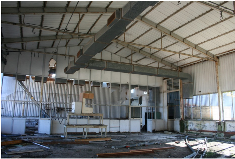
PIANO COTRUITO IN ACCIAIO DA RIMUOVERE – COPERTURA IN AMIANTO – VISTA INTERNA
