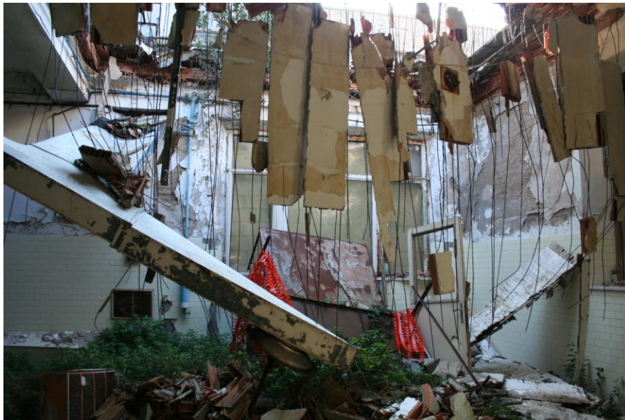
EDIFICIO "A" – ALTRI SOLAI CROLLATI
