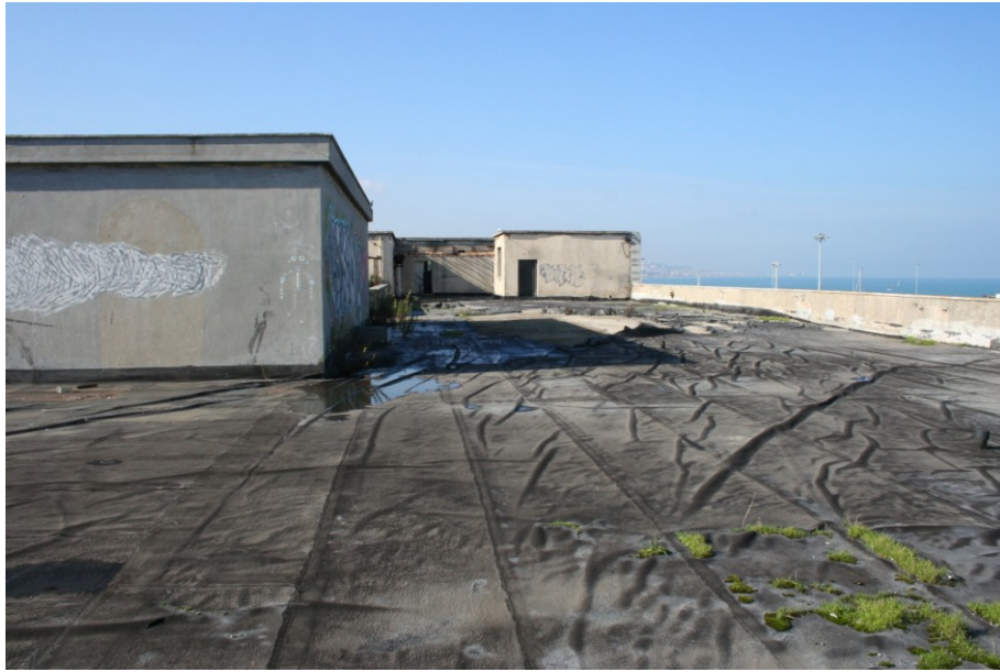
EDIFICIO "A" – COPERTURA: IMPERMEABILIZZAZIONE AMMALORATA
