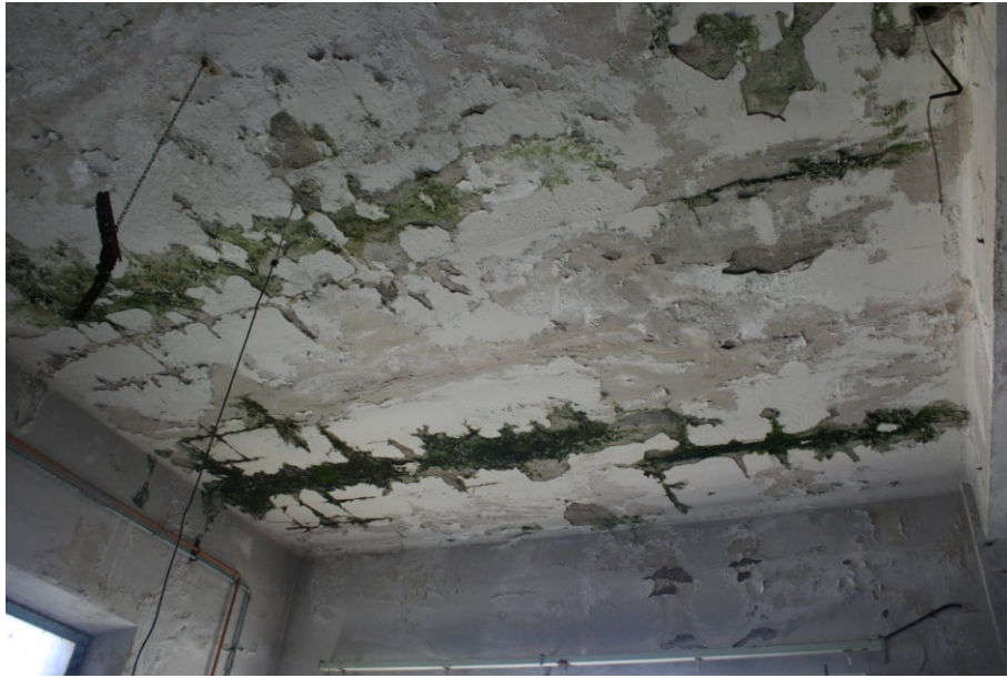
INTERNI CON SOLAI CON EVIDENTI SEGNI DI DEGRADO
