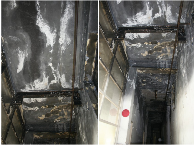
EDIFICIO "A" – SEGNI DI INCENDI INTERNI
