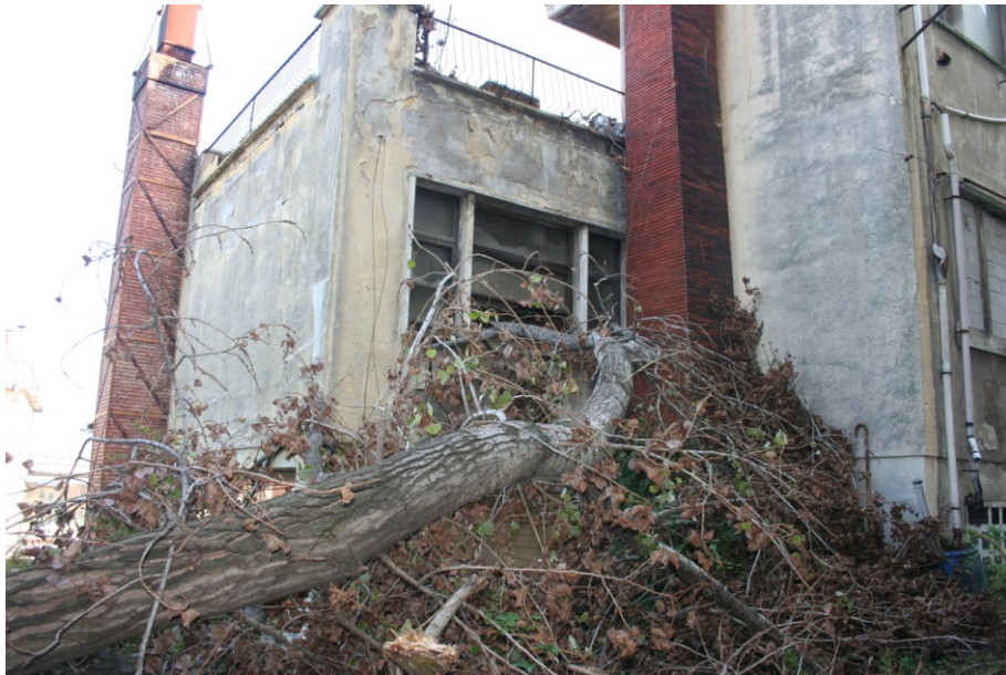
ALBERO CROLLATO DA RIMUOVERE
