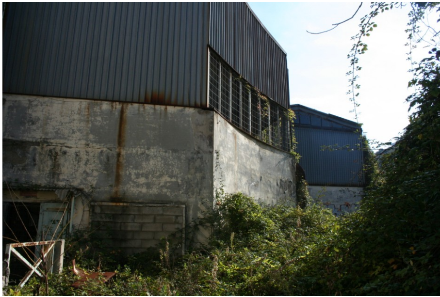
PIANO COSTRUITO IN ACCIAIO DA RIMUOVERE – COPERTURA IN AMIANTO
