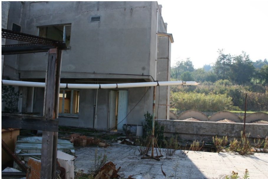
EDIFICIO "A" – SOLAIO DI COPERTURA CROLLATO
