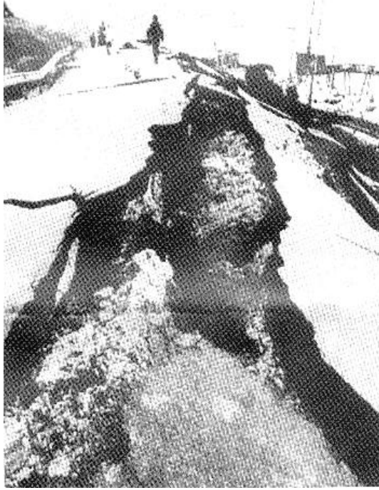
Fig. Fronte frana – Uscita nord città, Statale e ferrovia
