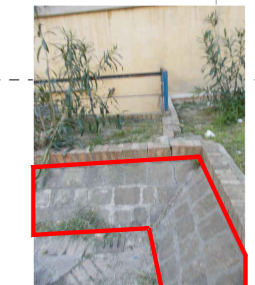
la pavimentazione in pendenza in mattoni verrà realizzata esattamente come quella già presente
